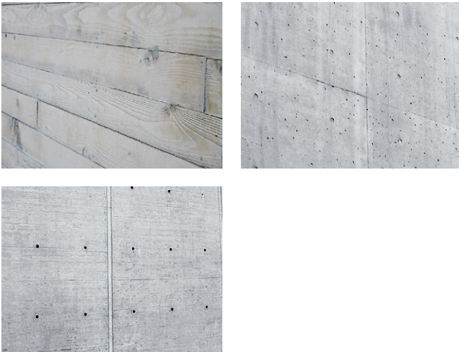
Abb. 27: Beispiele für geschlossene, weitgehend einheitliche Oberfläche mit Versatz, Graten und Rahmenabdruck der Schalung
