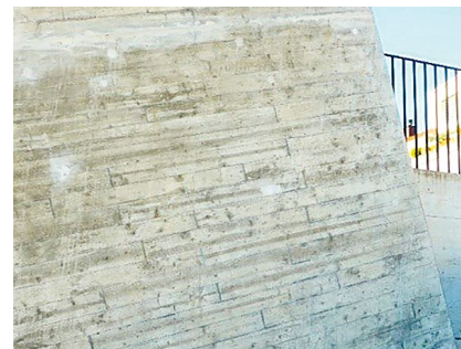
Abb. 53: Gespachteltes Kiesnest bei Schalungsstoss
